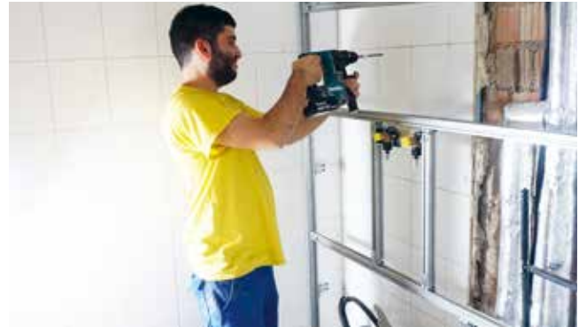
Dank guter Planung und erfahrener Handwerker gingen die Sanierungsarbeiten in der Sudetenstraße 5/7 flüssig von der Hand
