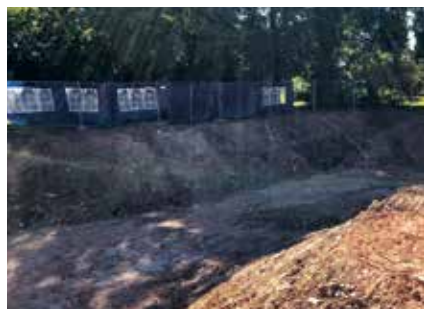
Nach dem erfolgten Abriss des Vorgängerbbaus steht die Baugrube nahe des Bürgerheims bereit.
